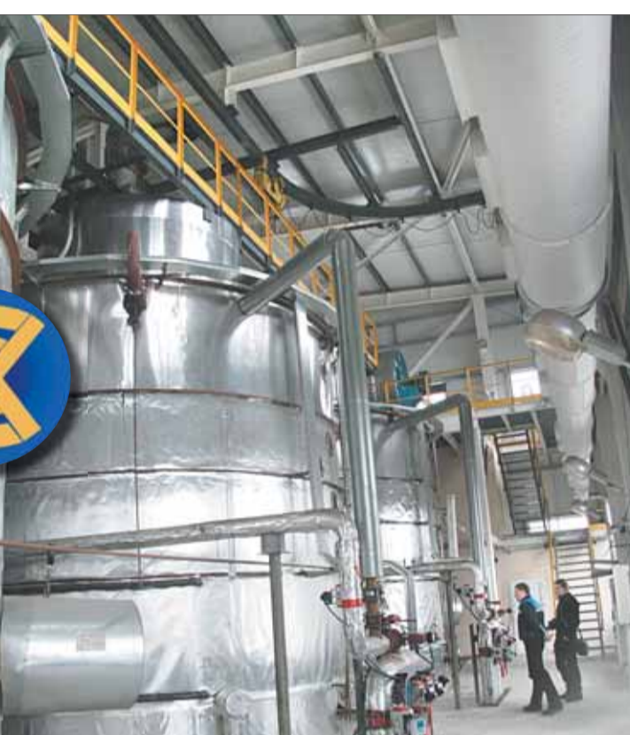
Аддзяленне ўварвання ўтфелю аснашчана сучасным высокапрадукцыйным абсталяваннем.
